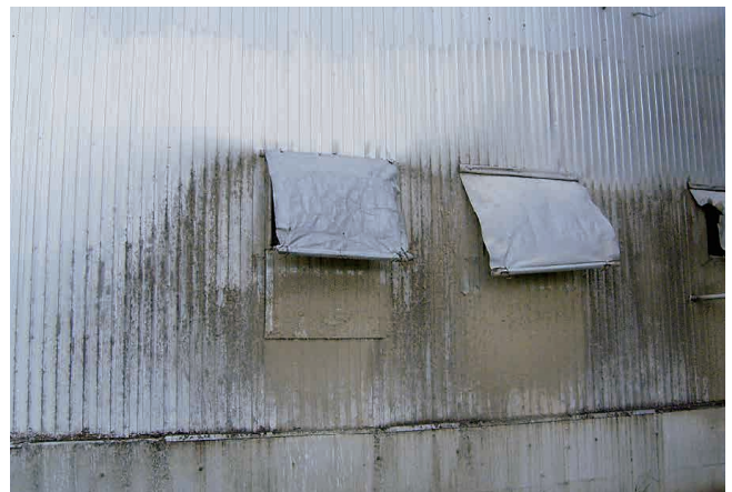
写真ー１ 牛舎の赤錆発生例（北海道）
