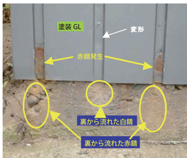
写真-2 塗装GL製角波壁材のコンクリート接触腐食
