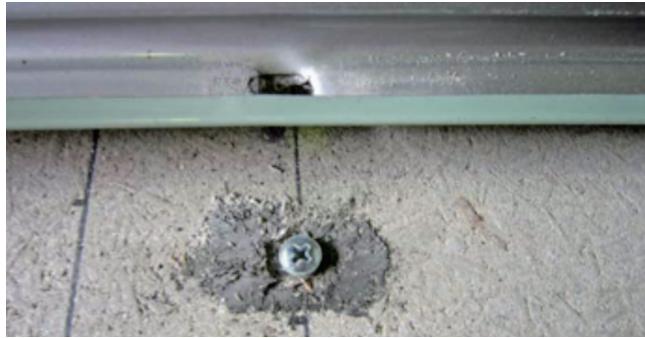
c. 試験体 C-2 (鋼板のねじ頭抜け)
