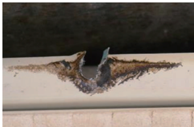
参考写真 屋根ぶき材の端切れ
