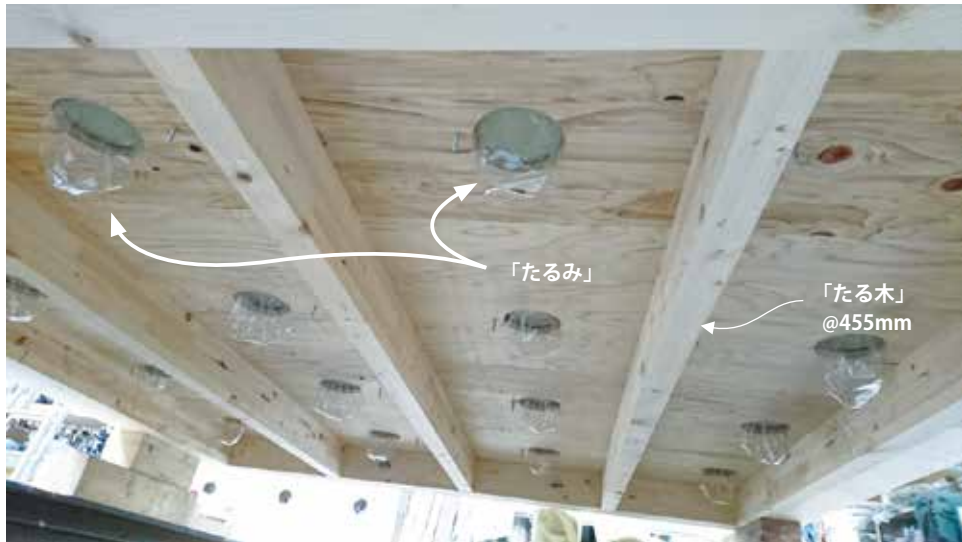
写真2 気密ビニルの「たるみ」の状況
