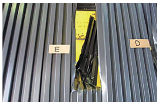
d. ミサイル E の衝撃による開口（一般部、屋外側）
