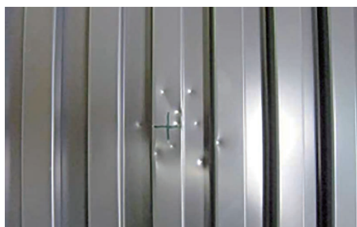
a. ミサイル A 衝突痕（一般部、屋外側）
