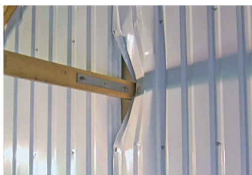
b. ミサイル E の貫通（重ね部、屋外側）
