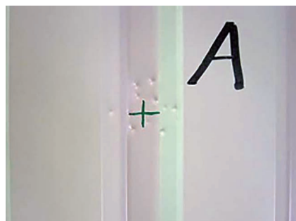
a. ミサイルA衝突痕（一般部、屋外側）
