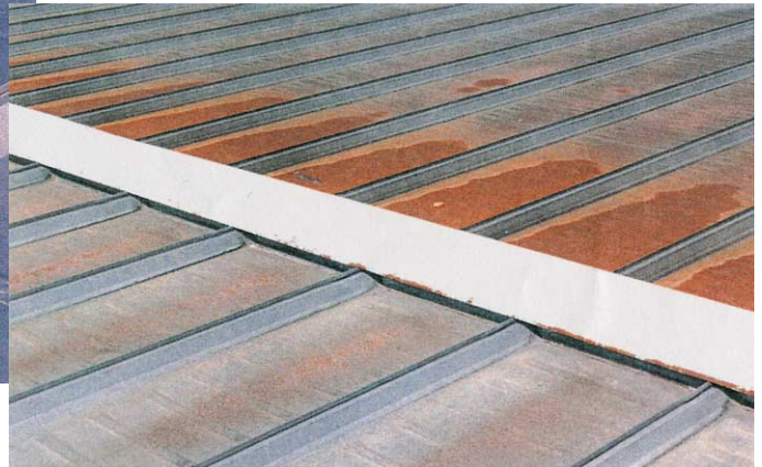
ガルバリウム鋼板製屋根の水溜り部の腐食状態 (20年経過)
