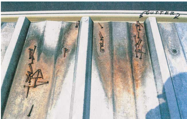
ガルバリウム鋼板製屋根の鉄くぎからのもらい錆による腐食状態
