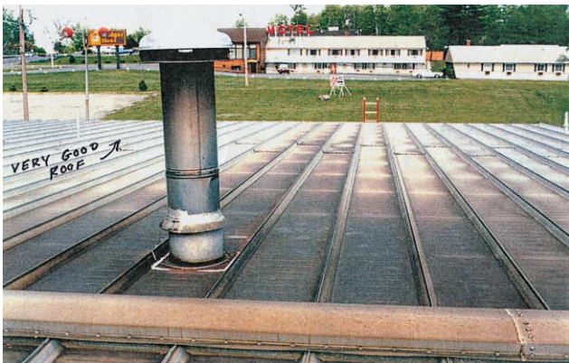
ガルバリウム鋼板製屋根の煙突近傍部の腐食状態 (17年経過)
