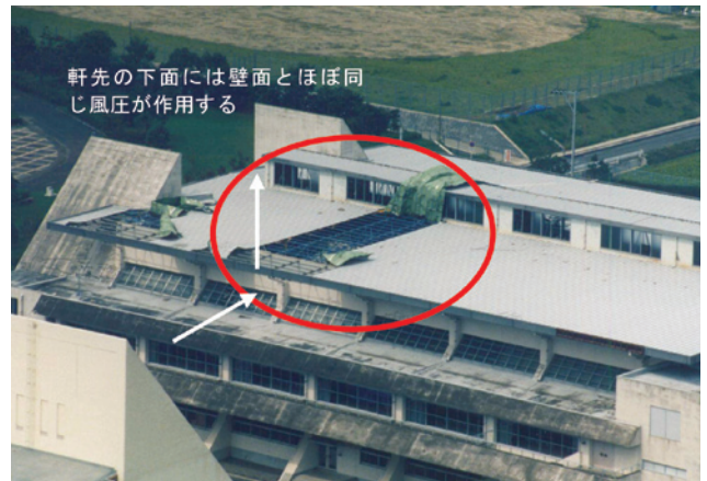
写真1 軒先から剥離した折板の被害例
