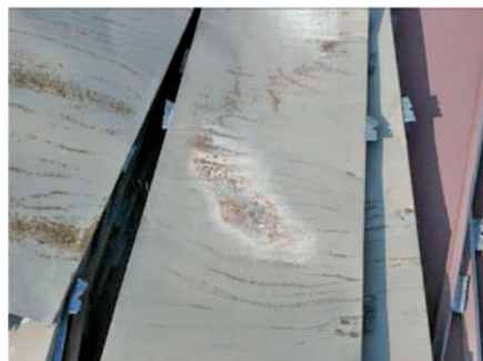
図12 金属屋根の裏面腐食
