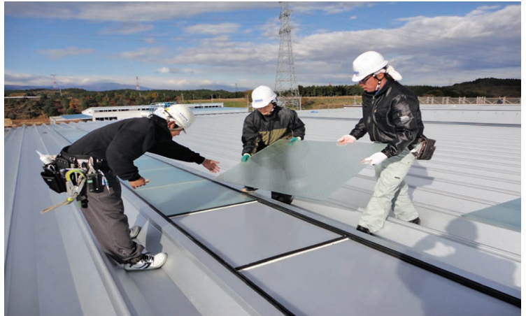
割れたガラスとその復旧
