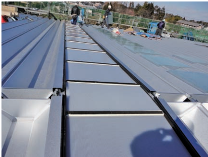
拡散板のシール
