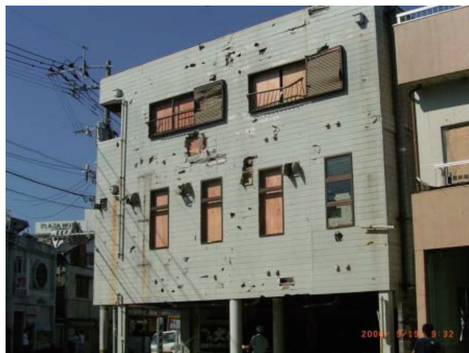
写真2 延岡竜巻での飛来物による被害 (延岡市役所提供)
