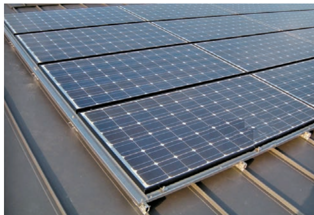
写真1 金属製屋根葺き材に固定された太陽電池パネル
