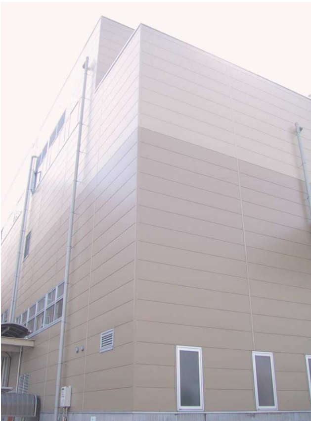
写真9 金属サイディング（広幅製品）を中層建物の外壁に使用した例
