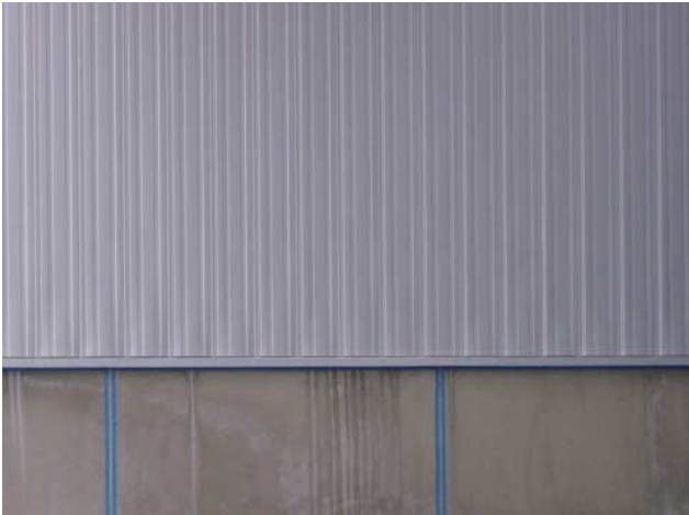
写真4-1 腰水切の納め（面戸のふくれとなるひずみ）
