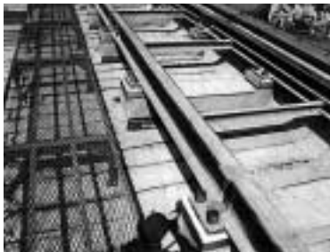
窓拭き用ゴンドラレール架台
